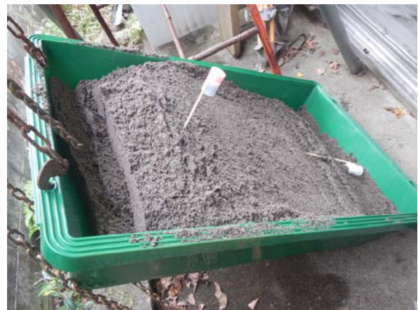
図-2 崩壊した斜面
