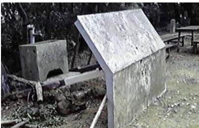
「見事に倒壊した不動堂手洗い場の屋根
